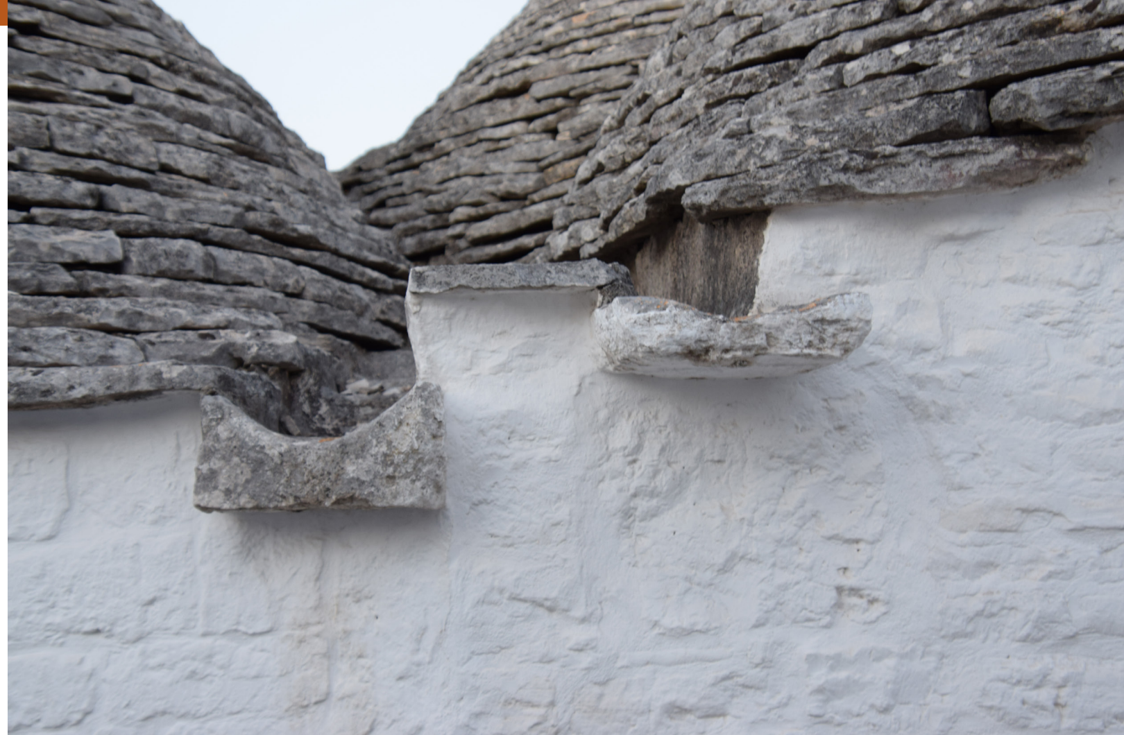
Imagen de los desagües vertiendo hacia la calle
