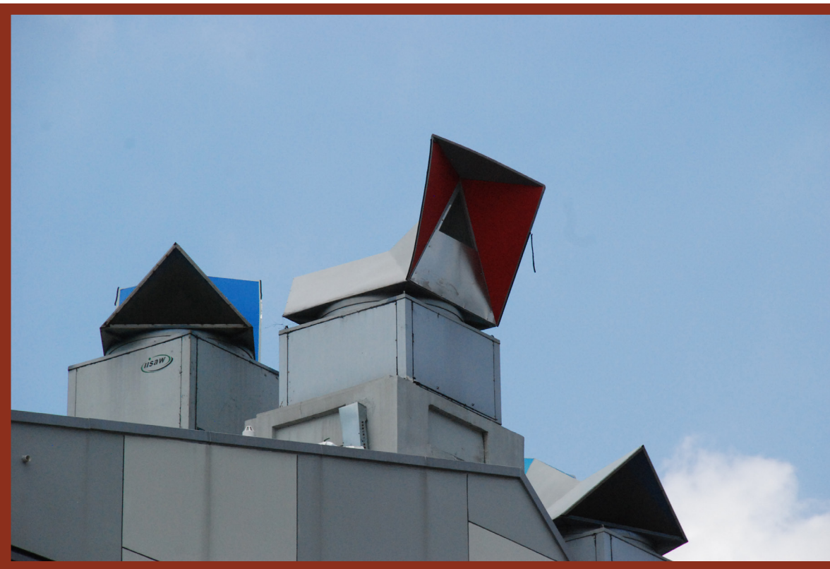
Sistema de ventilación con remate orientable y recuperador de calor, pabellón de la ciudad de Londres, Expo de Shanghai
