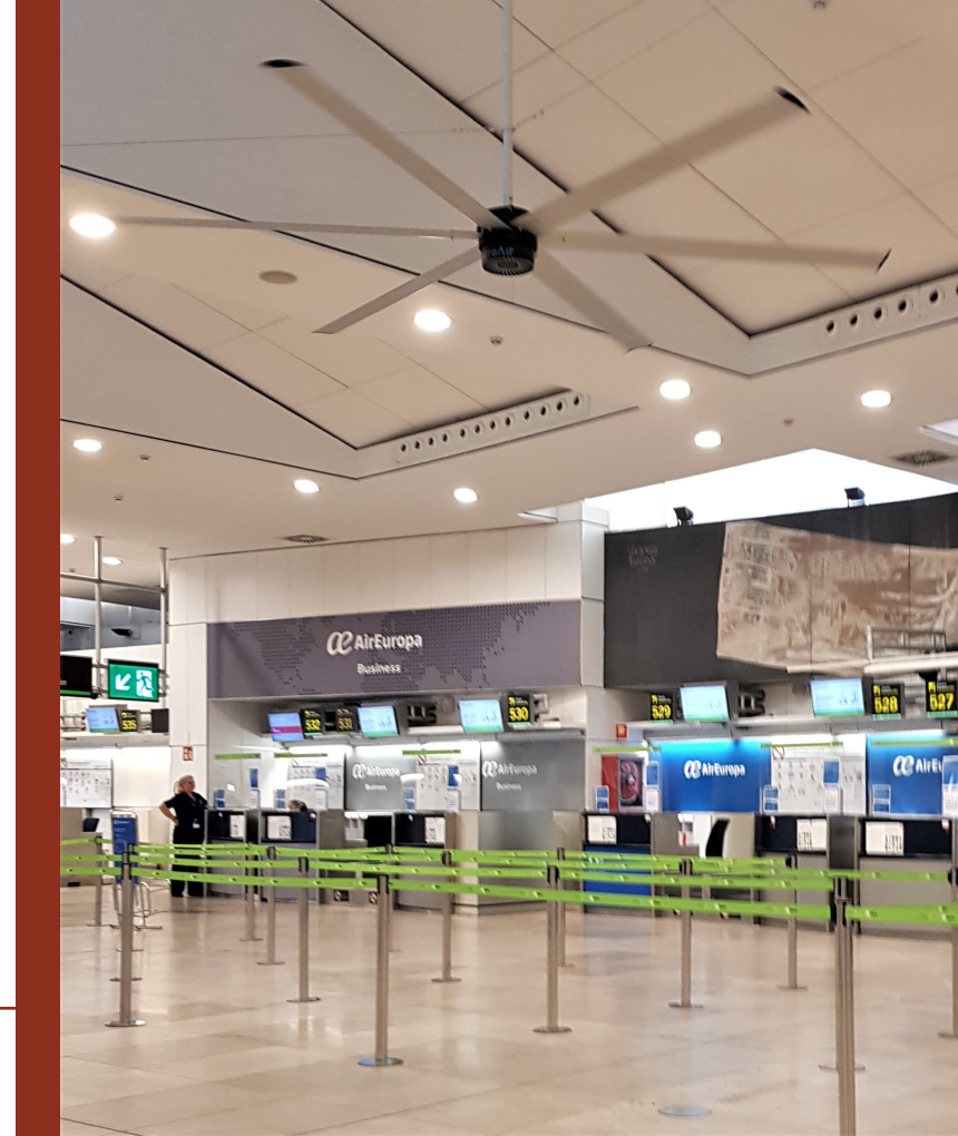
Grandes ventiladores de techo en la T2 del aeropuerto de Barajas en Madrid. Estos sistemas permiten ahorrar mucha energía de refrigeración al reducir directamente la sensación de calor
